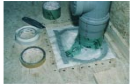
Sorgfältige Abdichtung einer Rohrdurchdringung durch eine unterste Holzleichtbau-Decke mit luftdichtender PE-Folien-ebene im Passivhaus Detmold (1998).
