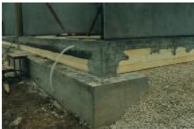
Unterseitig gedämmte Ortbeton-Sohlplatte auf 30 cm Hartschaum-Dämmlage über Streifenfundament. Geringe Wärmebrücken an Eckabstützungen eines Passivhauses in Ulm (1999).
