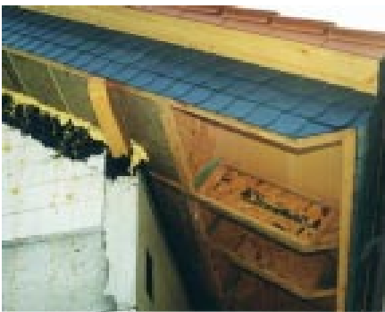
Dachstuhl aus 40 cm hohen einlagigen Filigranträgern und Steinwoll-Dämmung der WLK 035 im Passivhaus in Porta Westfalica
