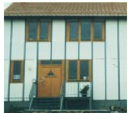
Wärmebrücken rund um Fenster und Türen sowie am Sockelanschluß bei einem Holzleibbeu-Niedrigenergiehaus in Detmold (1991)..
