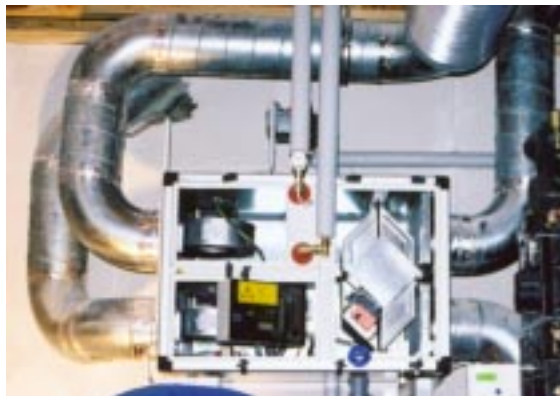
Moderne Lüftungsanlage mit hoch-effizientem Gegenstrom-Wärmetauscher und verbrauchsarmem Gleichstrom-Motor in der Baugröße für ein Einfamilienhaus (Westaflex).
