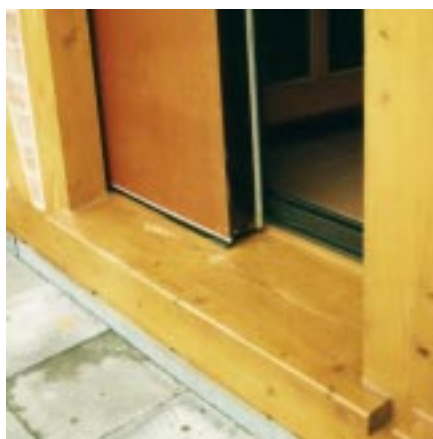
Verdeckt eingebaute Dämm-Schiebeläden im Nullenergie-Haus in Beelen (1996).
