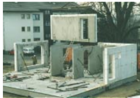
Leichtbeton-Fertigteile mit werksseitig montierter PS-Dämmung an Passivhäusern in Marktoberdorf (1998) und ähnlich in Ulm (1999).
