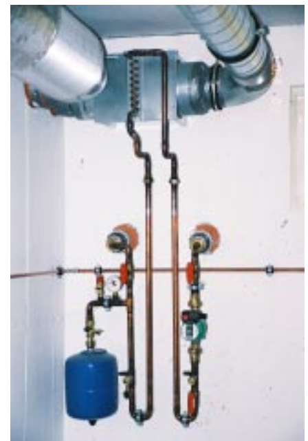
Keller-Installationen eines solebetriebenen Erdwärmetauschers in Rheda mit ca 60 m Rohrlänge rund um das Fundament eines EFH. Oben im Bild das Frischluft-Vorheizregister, unten Pumpe und Druckausgleich (NEI 2001)
